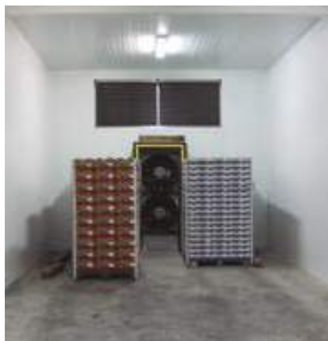
Figura 20. Almacenamiento en cuartos fríos para aguacate. Fotos: J. Bernal
